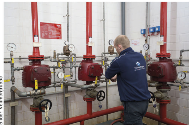
Sprinkleranlagen werden alle sechs bis zwölf Monate gewartet.
